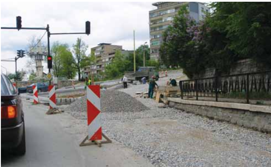
Реконструкцията на кръстовището започна през септември миналата година и ще завърши за 9 месеца Снимка авторът
