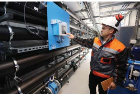
Станимир Герзов, ръководител на цех „Пречиствателни станции и хидротехнически съоръжения“ в „Елаците-Мег“ показва новото пречиствателно съоръжение
